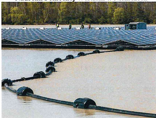
Rysunek 3 Pływająca farma fotowoltaiczna na zbiorniku Silberseen und Schmaloeer Heide w Nadrenii Północnej Westfalii w Niemczech
